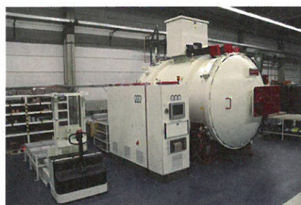
Neue Vakuumofenanlage, die 3500 kg Material pro Charge und damit die 6-fache Kapazität des alten Ofens verarbeitet (VAU Thermotech GmbH & Co. KG)
